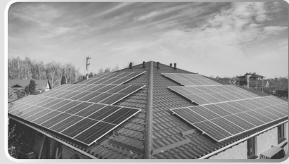
Bir konutun çatısına uygulanmış fotovoltaik hücreler
